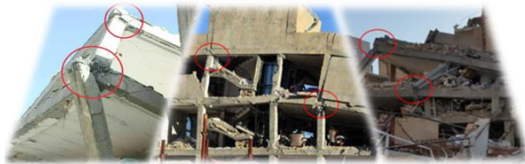
شکل ۱: اتصالات آسیب دیده ی تیر به ستون بتن مسلح در اثر زلزله ۲۰۱۷ کرمانشاه، ایران (Akbar et al., 2019)
