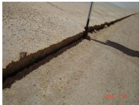
شکل ۱- تصویری از محل‌های آسیب دیده و شکل شماتیک
