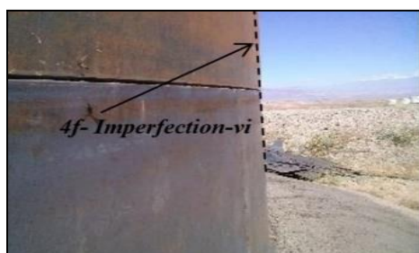
شکل ۴- ناکاملی مربوط به انحراف بدنه مخزن از راستای قائم (ناکاملی بدنه اریب)
